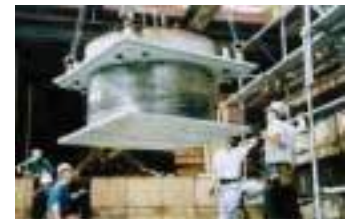
Instalación de un aislador de 1500mm de diámetro para el Condominio High City Kyosumi en Japón.
